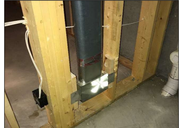
10. Aire de retorno canalizado y sellado.
