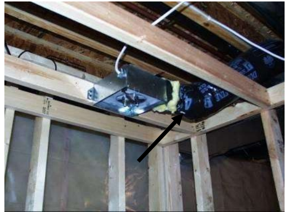
8. Conducto flexible aislado del extractor del baño que da al exterior, a un mínimo de 3 pies de la pared exterior en el que se requiere el aislamiento
